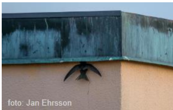
Ingång till boplatser genom spalt bakom takkantplåt.
