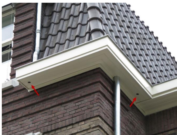
Ingång till boplatser genom hål in i en iklädd takfot.
